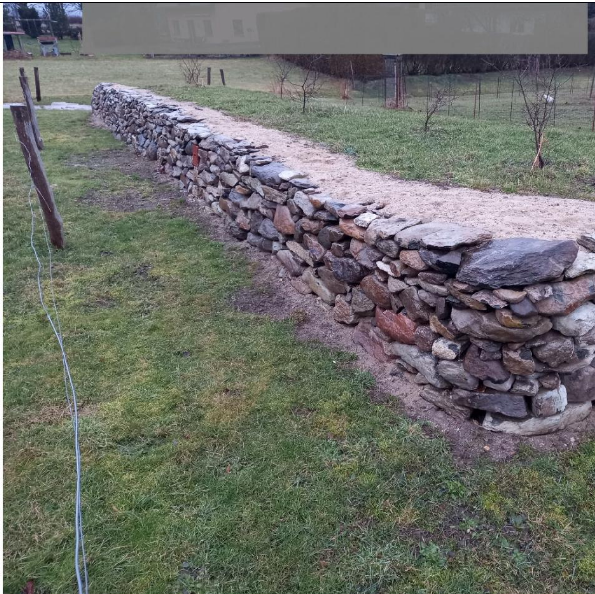
Abbildung 4: Natursteinmauer mit Hinterfüllung aus übererdeten, frostfrei liegenden Depots aus Kies, Lesesteinen und Totholz. Die Schlehensträuchern bepflanzt, die mittelfristig eine Heckenstruktur bilden sollen.
